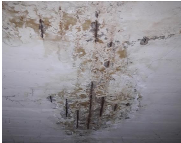
Figura 36 Carbonatación en losa
