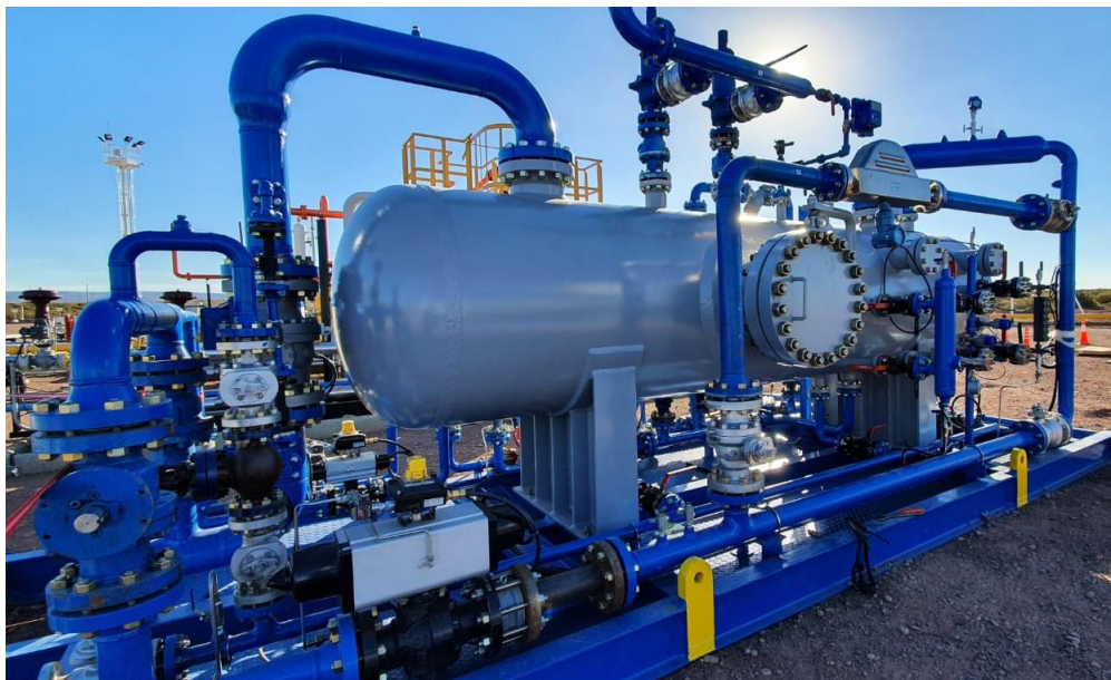
Figura 3. Separador trifásico con placa de rebalse
