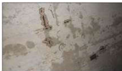
Figura 7: Losa del 2do piso con corrosión de sus armaduras, desprendimientos de hormigón dejando a la vista el poco recubrimiento dado a las armaduras.
