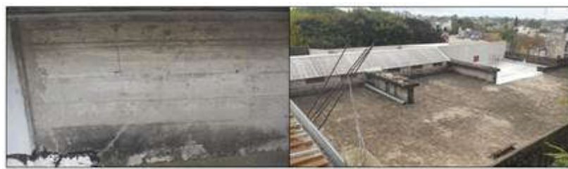
Figura 3: Fisura de corte en viga "T" (izq.). Terraza y vigas "T" (der.).
