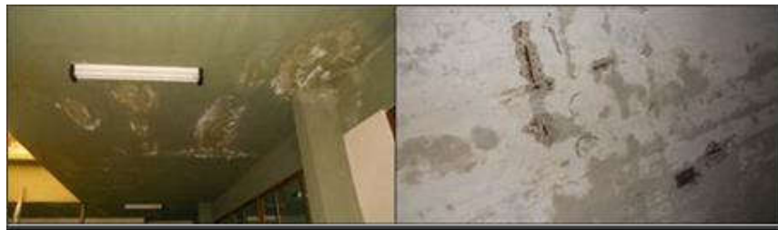
Figura 1: Lixiviación en losas sobre 1 er piso (izq.) y Corrosión y delaminación en losas sobre 2 do piso (der.).
