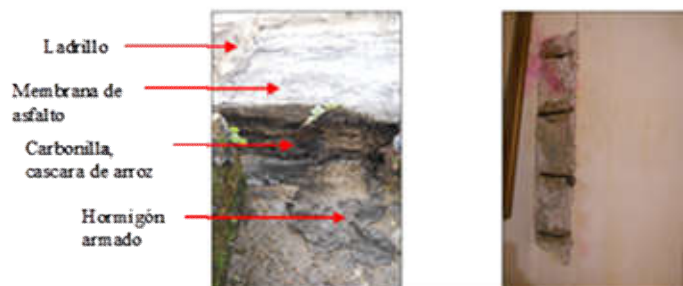
Figura 2: Detalle contrapiso losa terraza (izq.) y Columna 2 do piso con corrosión y desprendimiento de hormigón (der.).
