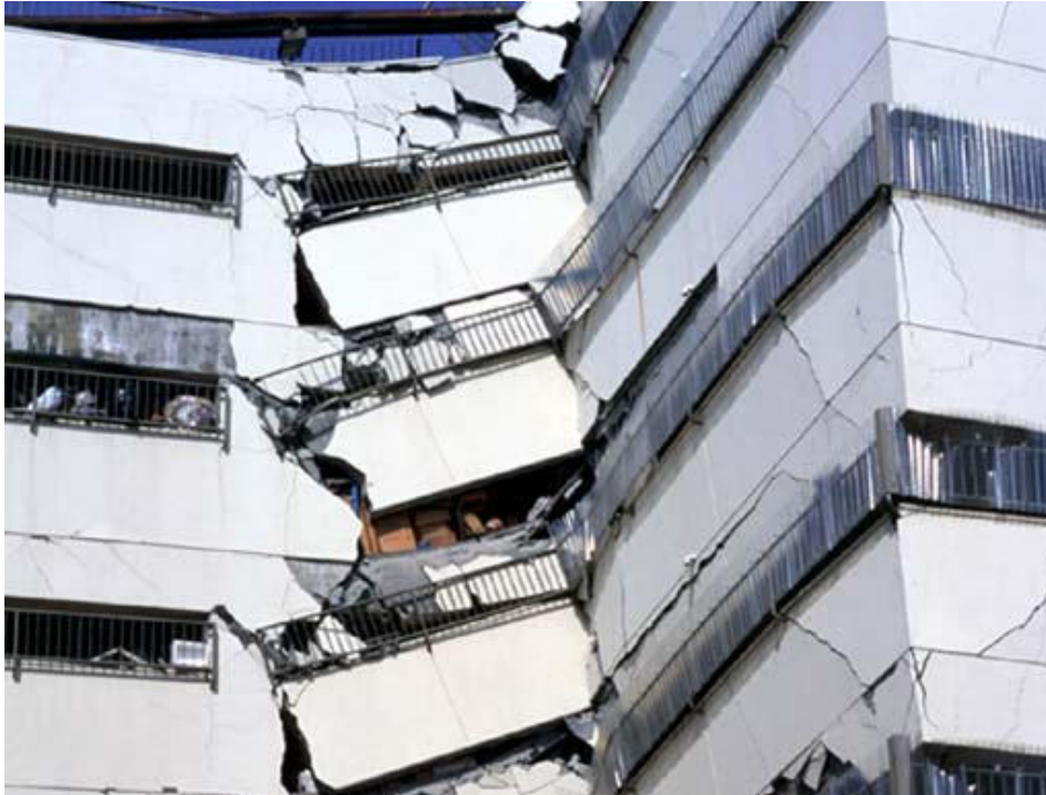
Figura 1.2.- Edificio colapsado en la ciudad de Kobe – Japón.
