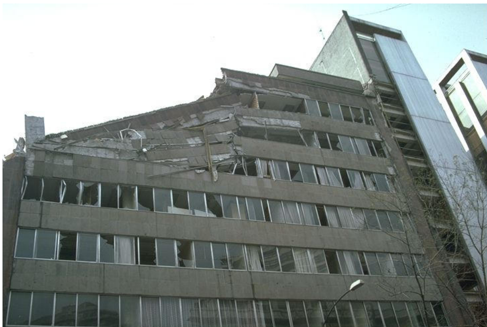
Figura 1.1.- Edificio colapsado en la Ciudad de México.
