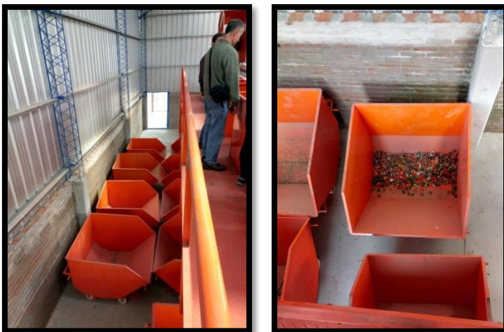
Figura 19: Foto vista interior de la planta de tratamiento - Tolvas. Fuente: Propia
