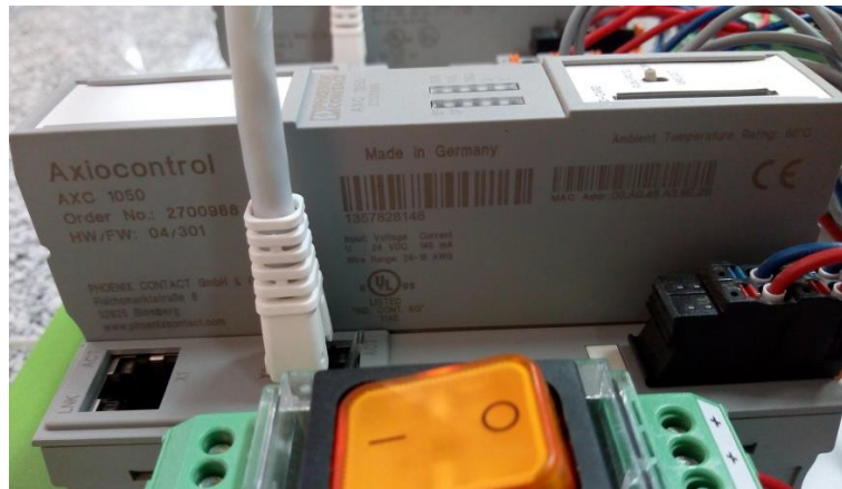
Figura 2 PLC Axioccontrol AXC 1050
