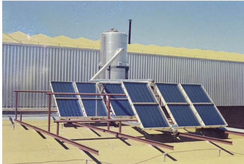
Figura 5-6: Ejemplo de un colector plano de placa plana con el termotanque. Referencia [33].
