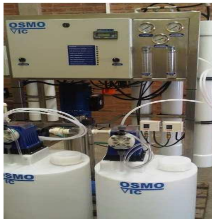
Figura N°50: Equipo osmosis inversa IO-501
