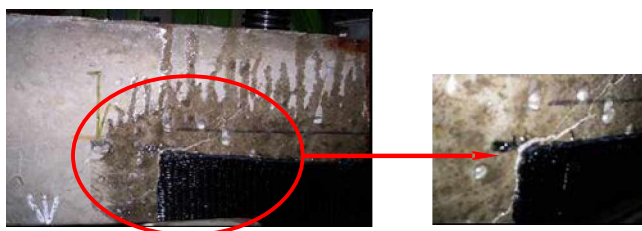
Viga corroída y reparada
