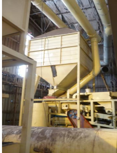
Figura 3-12: Sector de pre limpieza
