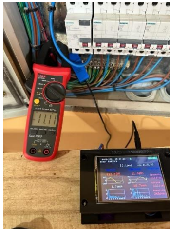
Figura 40 Medición de corriente comparativa entre pinza y equipo en tablero eléctrico
