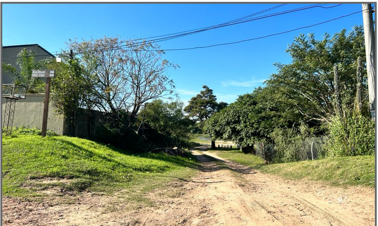
Callejón Montenegro, Intersección con terraplén Ubajay - Falta de mantenimiento en calles
