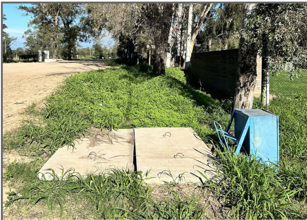
Estación de bombeo N° 1 - Calle Santa Rosa y Callejón Pintos
