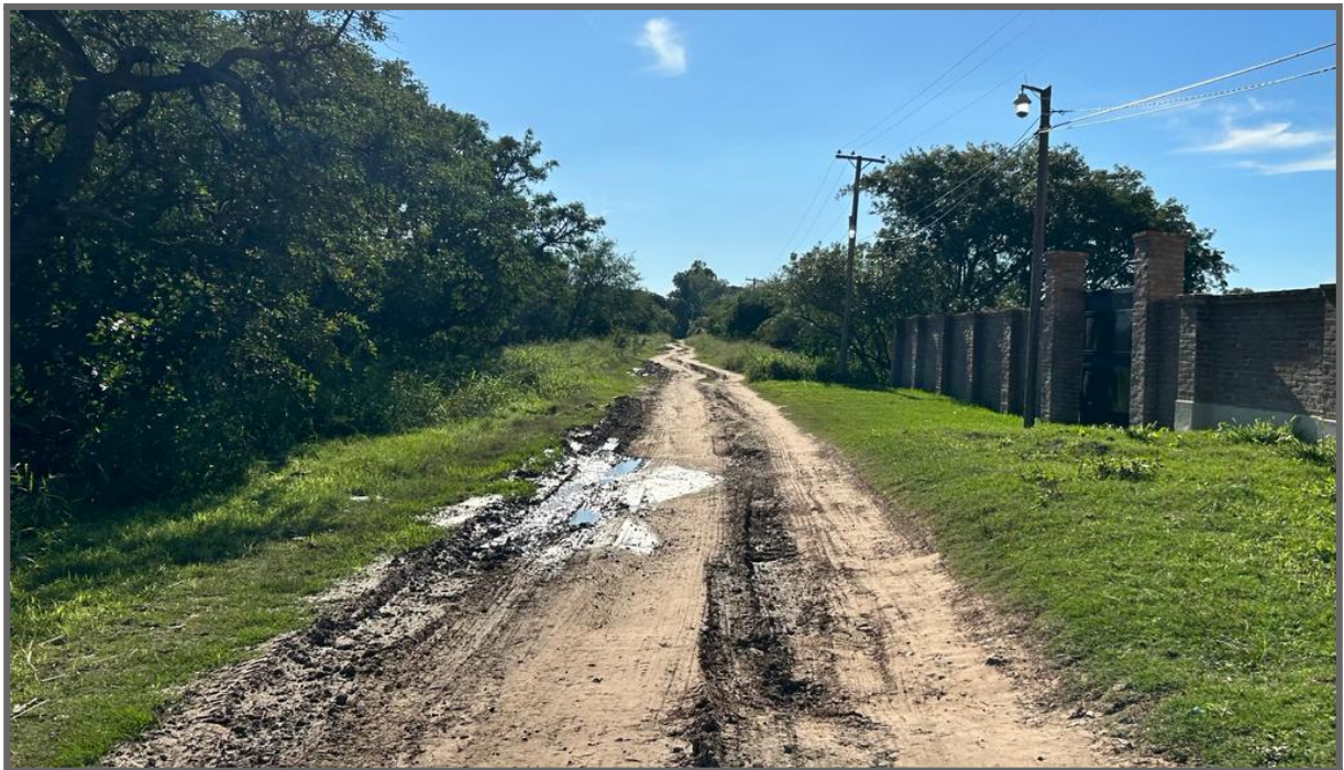
Terraplén Ubajay - Anegamientos varios días después de las lluvias. Falta de cunetas y pendiente de escurrimiento de calzada.
