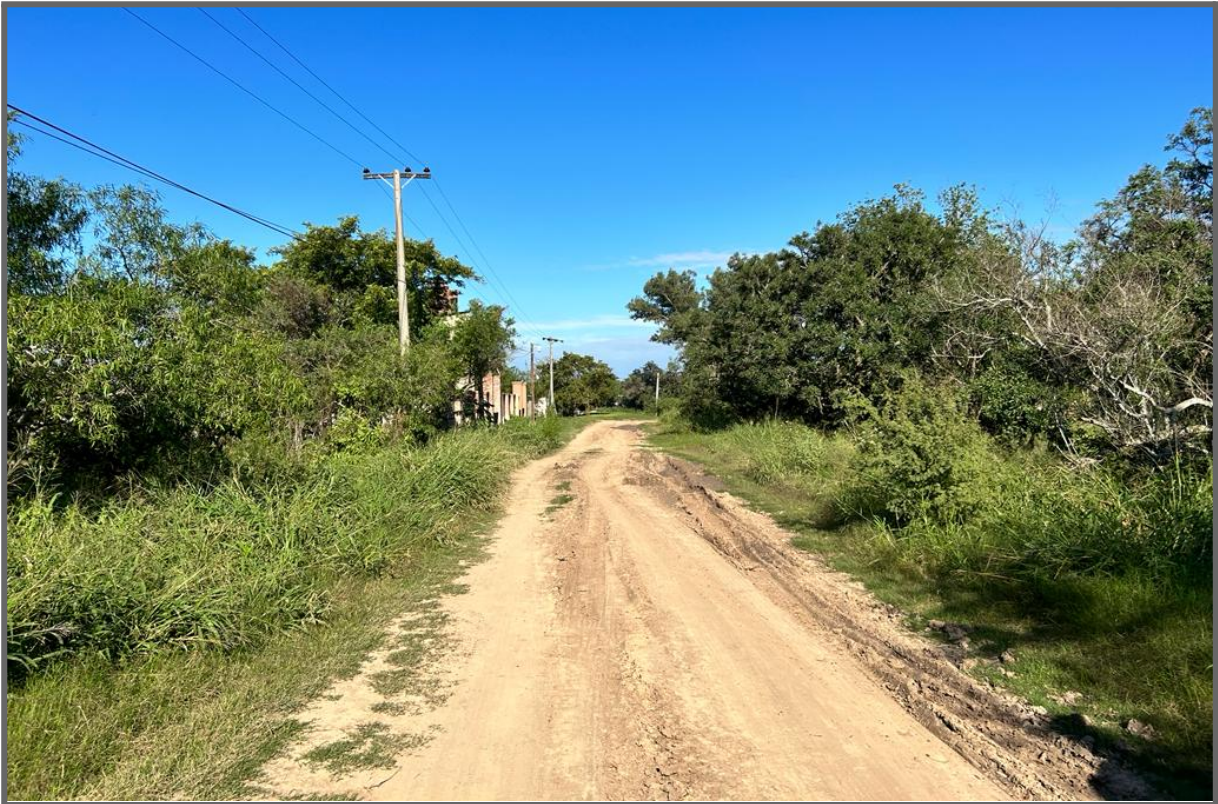
Terraplén Ubajay - Anegamientos varios días después de las lluvias. Falta de cunetas y pendiente de escurrimiento de calzada.
