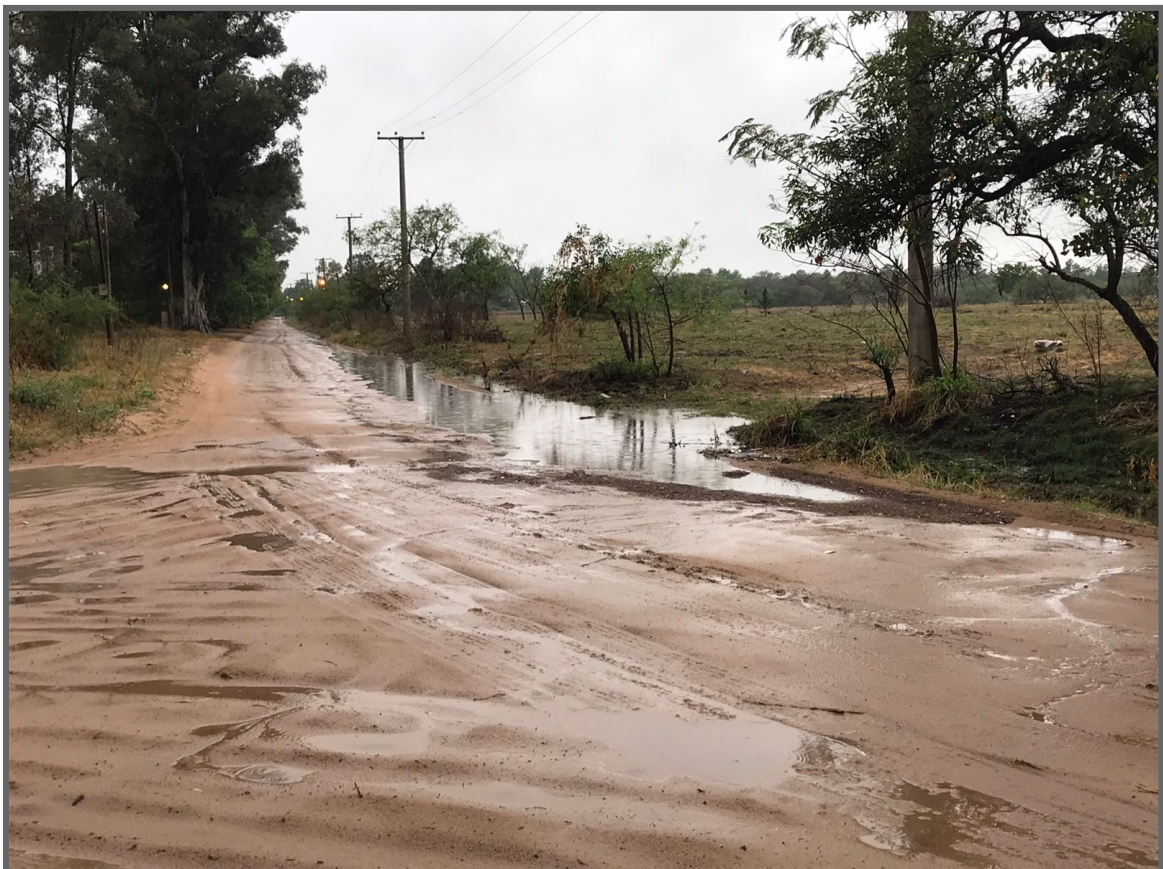
Santa Rosa y Callejón Montenegro - Acumulación de agua de lluvia
