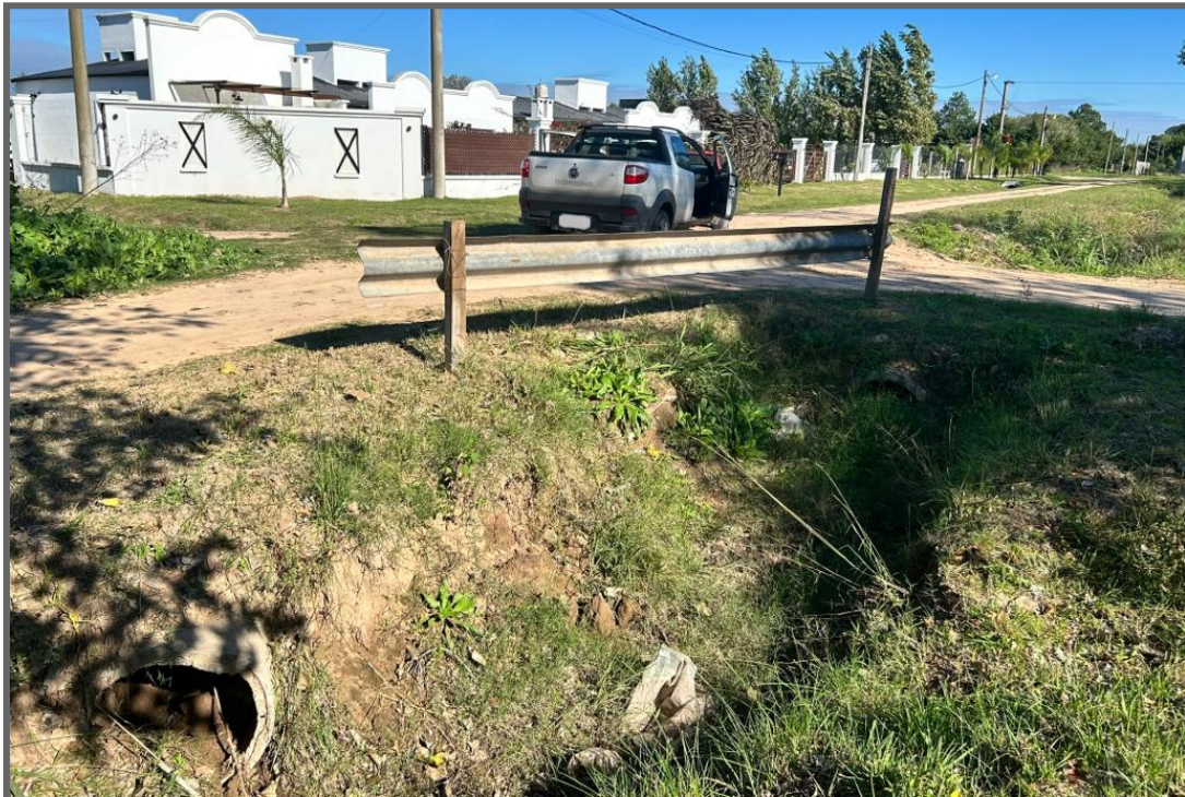
Calle Molinas, intersección Ricardo Supisiche - Falta de mantenimiento en canales, y conductos con sección reducida.
