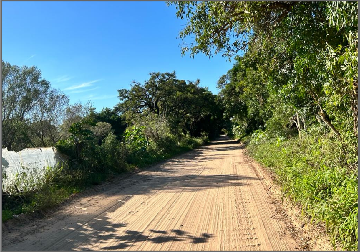
Callejón Montenegro - Falta de cunetas y pendiente transversal en calzada
