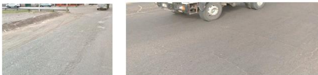
Figura 95. Deterioros en Carril Rodríguez Peña. Fuente: Elaboración Propia
