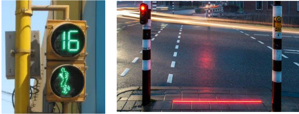
Figura 107. Semáforo con protección al peatón. Fuente: imágenes obtenidas de Internet.
