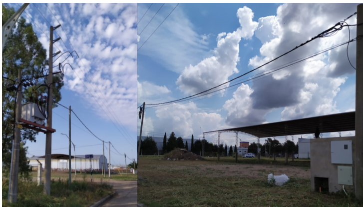
Figura 10.1.1: SETD y red eléctrica aérea
