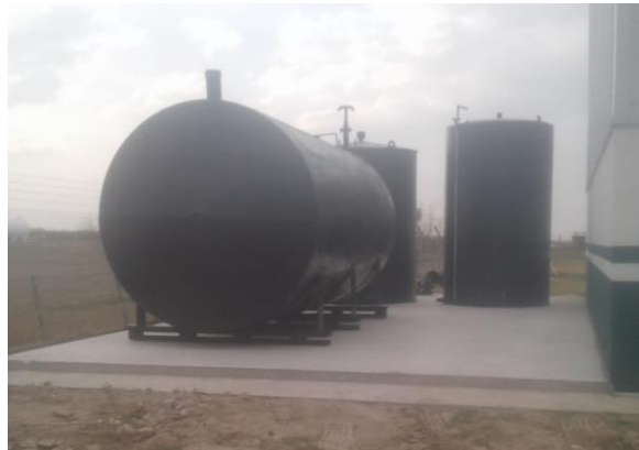
Ilustración 29: Tanque de fuel oil
