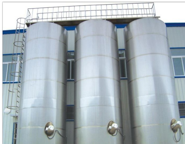
Ilustración 18: Silos de acero inoxidable
