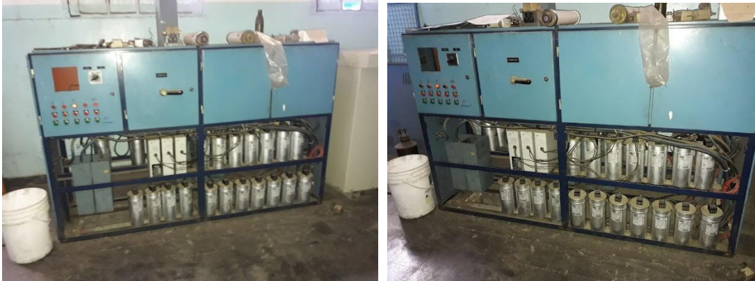
Vista del TGBT 2-a donde compensa el Banco de Capacitores Manual
