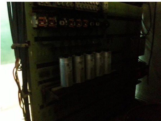
Capacitores por cada bomba de vacío
