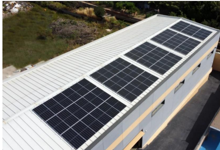
Figura 113. Paneles Fotovoltaicos en cubiertas.
