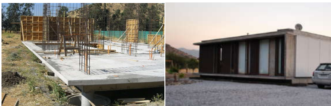
Figura 2.30. Vivienda con sistema de aislamiento sísmico construida en Chile en el año 2009.
