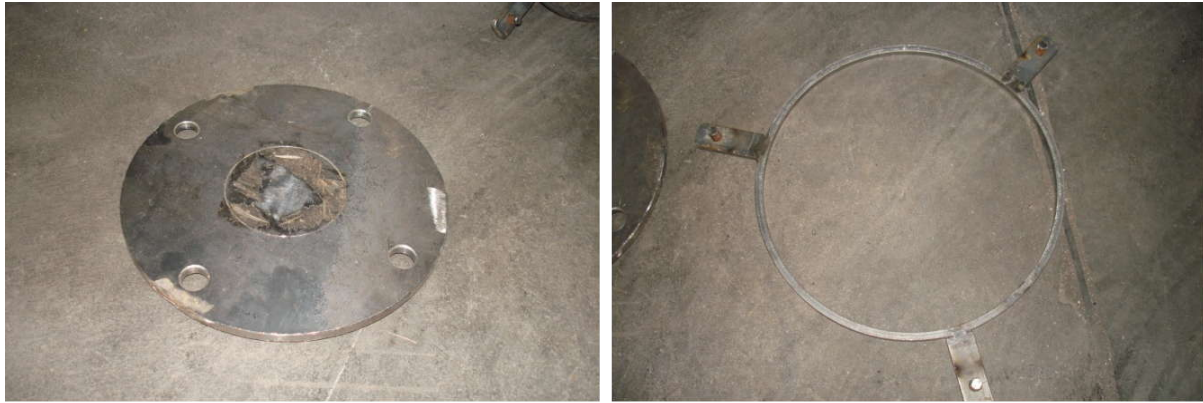
Figura 4.15. Fotografías de una de las pletinas de conexión inferior y superior y el anillo de centrado.
