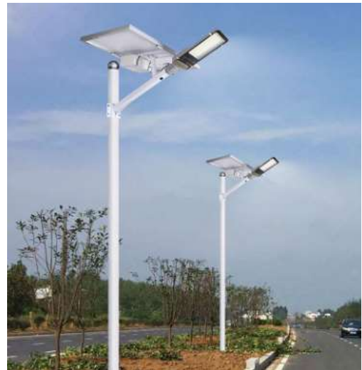
Figura N°77 Red de iluminación urbana (híbrida)
