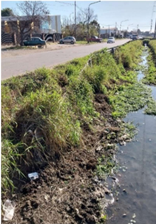
Figura N°25 Desmoronamiento de talud y guardarrail
