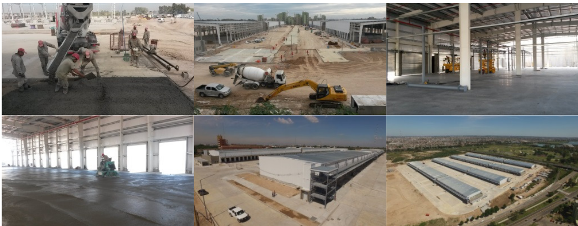
Figura 5: Construcción del pavimento en el Centro de Transferencia de Cargas de Buenos Aires empleando hormigones con macrofibras sintéticas.
