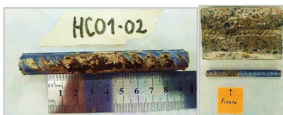
Figura 4: Deterioro en zona de fisuras en HC (izquierda) y en HRF (derecha).
