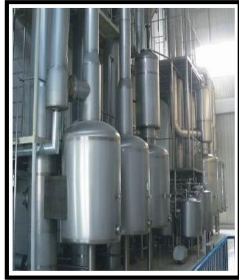
Ilustración 30: Evaporador de Dos Eficiencias
