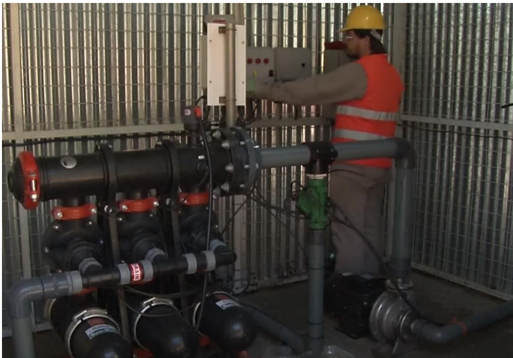
Figura 3.19 | Gabinete de bombas de sistema de riego.
