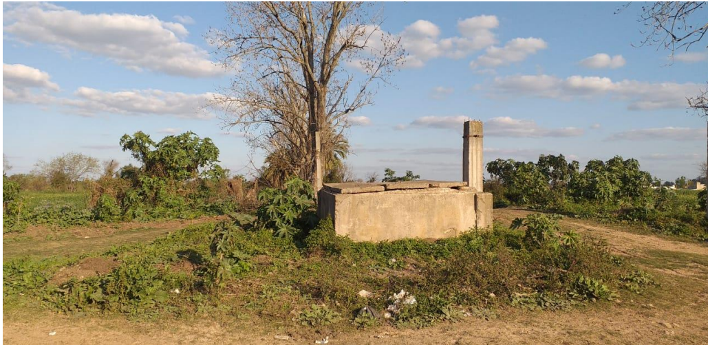
Figura 1 Cámara de ingreso a lagunas existentes.
