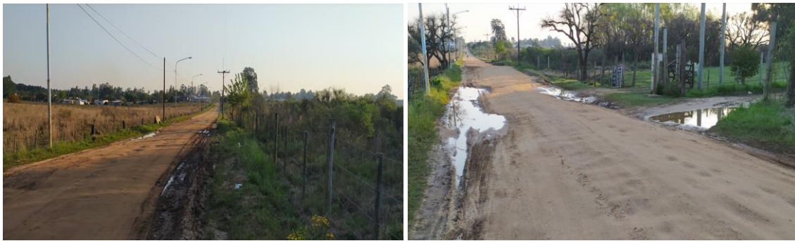
Figura 11 y 12: Estado de calzada: regular. Presenta zonas erosionadas y mal escurrimiento de aguas.
