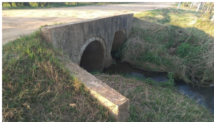
Figura 13: Alcantarilla de 2 caños de H° de 1100 mm, entre calles Scalabrini Ortiz y Canadá.
