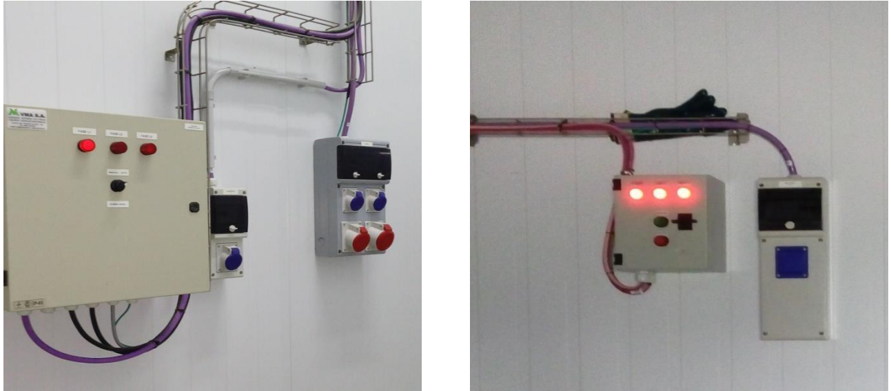
Figura 1.37. Tablero eléctrico de secaderos y sistema de rieleras.
