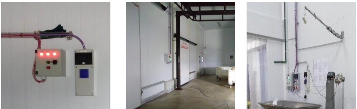
Figura 3.2. Tablero seccionales de área de rieleras, cámara de congelados y pesaje respectivamente.
