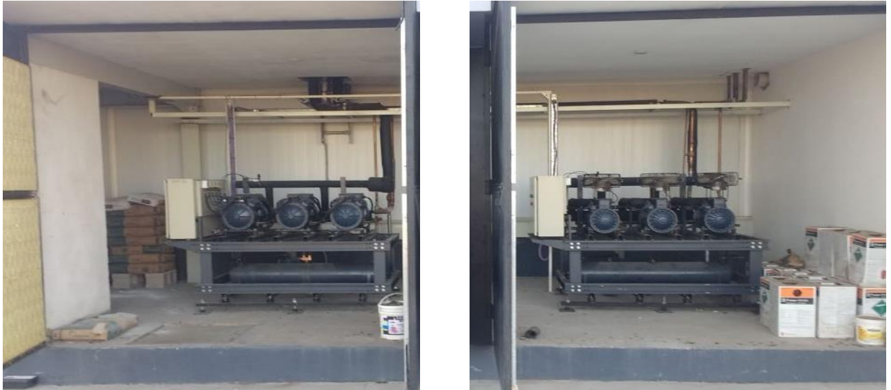
Figura 1.28. Central de enfriamiento 1 y 2.
