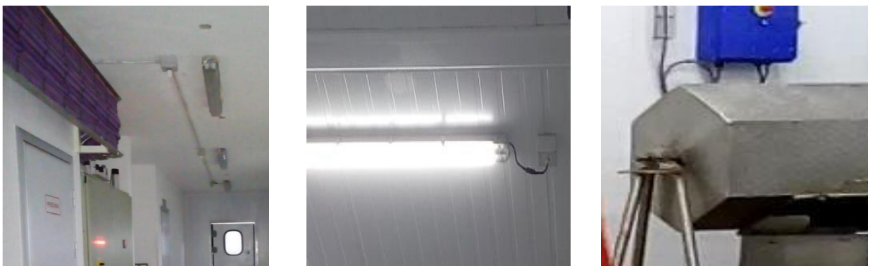
Figura 3.3. Iluminaria colgante y de emergencia. Conexión por medio de caja a equipos.
