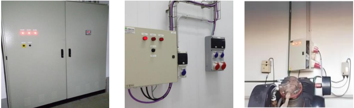
Figura 3.1. Tablero principal y tablero seccionales de secadero y compresores respectivamente.
