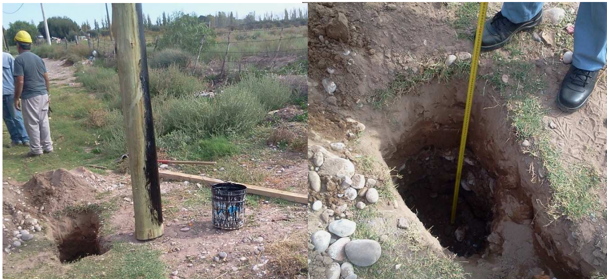
Verificación de pintura asfáltica en el poste y de profundidad de pozos
