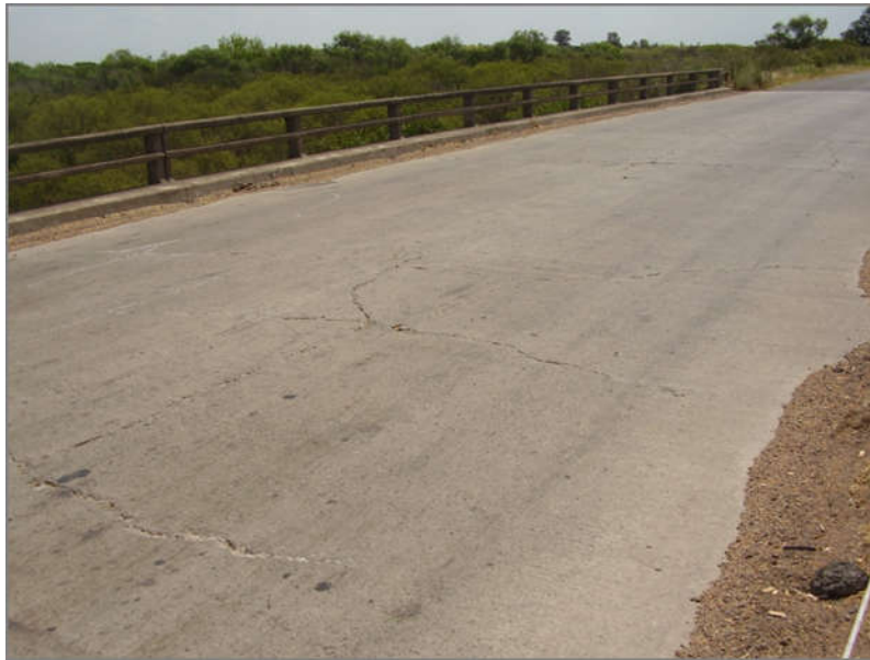
Vista de las múltiples fisuras del tablero del puente.
