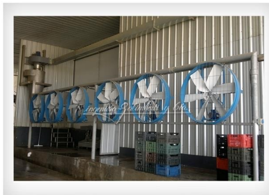
VENTILADORES PLAYA DE ESPERA
