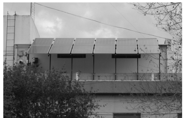
Fig. 1. Vista de los paneles solares fotovoltaicos instalados en la UTN-FRSFco
