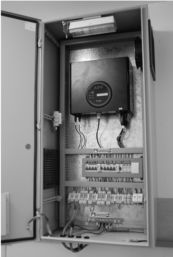
Fig. 2. Vista del tablero de operación y control donde se incluye el inversor electrónico
