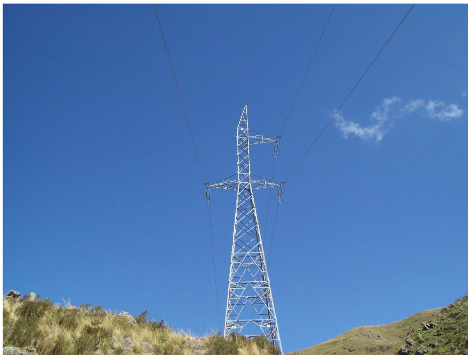
Fig. 12 LAT en disposición Triangular Provincia de Catamarca
