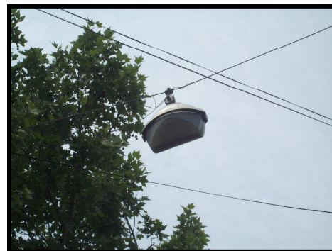
FIGURA II - 57 - Luminaria apta para suspensión, instalada en la zona céntrica, con lámpara de sodio de alta presión.
