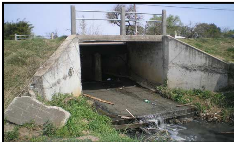
FIGURA III - 20 - Alcantarilla de dos bocas, ubicada en Bv. Ayuí entre Av. Monseñor Tavella y Av. Monseñor Rosch.
