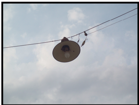
FIGURA II - 56 - Luminaria tipo campana, provista de lámpara mezcladora de 160 [W], suspendida en riendas.
