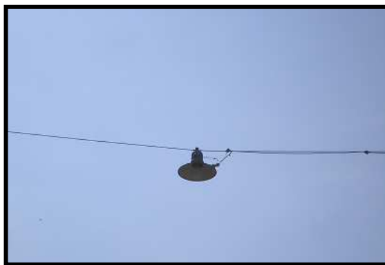
FIGURA III - 35 - Fotografía de luminaria suspendida sobre riendas de acero, utilizada para la iluminación de las calles del Barrio Golf.
