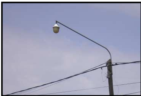
FIGURA III - 34 - Fotografía de brazos sobre postes, utilizado para la iluminación de las calles del Barrio Golf.
