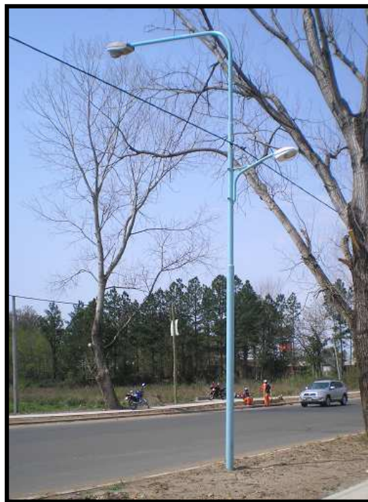
FIGURA III - 33 - Columnas metálicas del tipo jirafas, utilizadas para la iluminación de la Av. Independencia.
