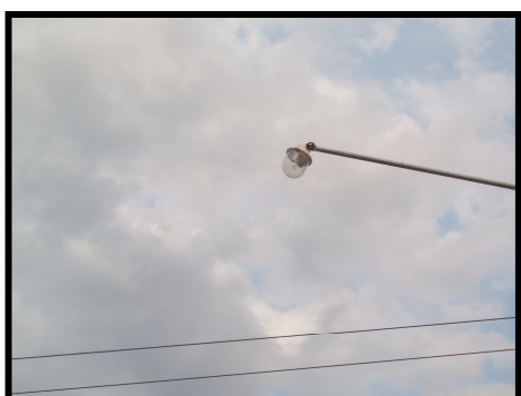
FIGURA II - 58 - Brazo metálico amurado en poste de madera, provisto de artefacto con lámpara de sodio de alta presión.
