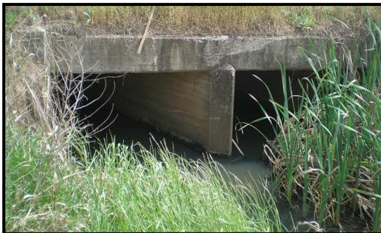
FIGURA III - 23 - Alcantarilla de dos bocas, ubicada a 40 metros de la intersección de Av. Monseñor Rosch y calle Chubut.
