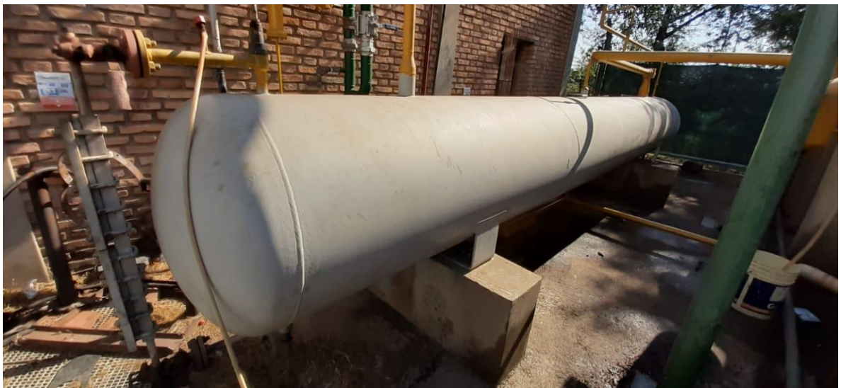
Imágenes sala de maquinas:
