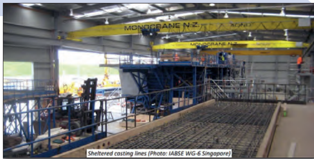
Figura 9B Equipos e instalaciones b) nave de promoldeados.
