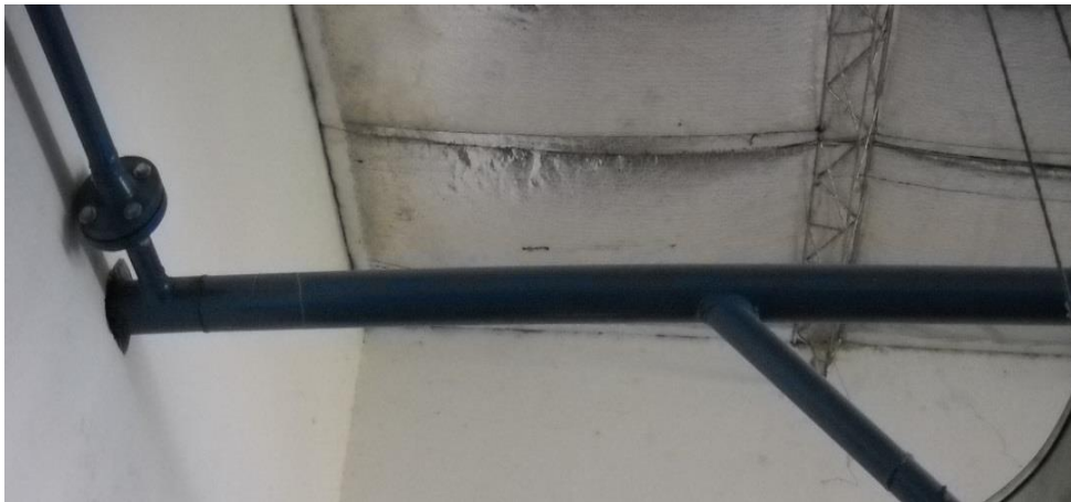
Figura 8- fuente propia. Imagen de cañerías para distribución de aire comprimido.
