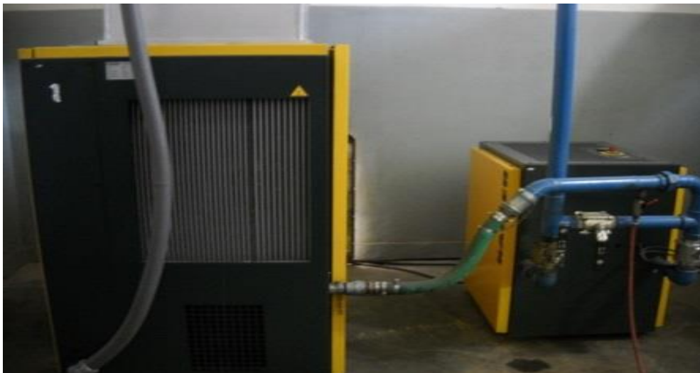
Figura 6- fuente propia. Imagen de compresor con su respectivo secador y filtrado de micro partículas.
