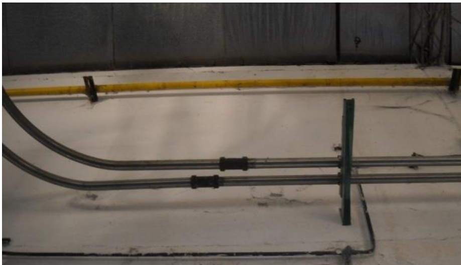
Figura 5- fuente propia. Línea de gas natural interna.
