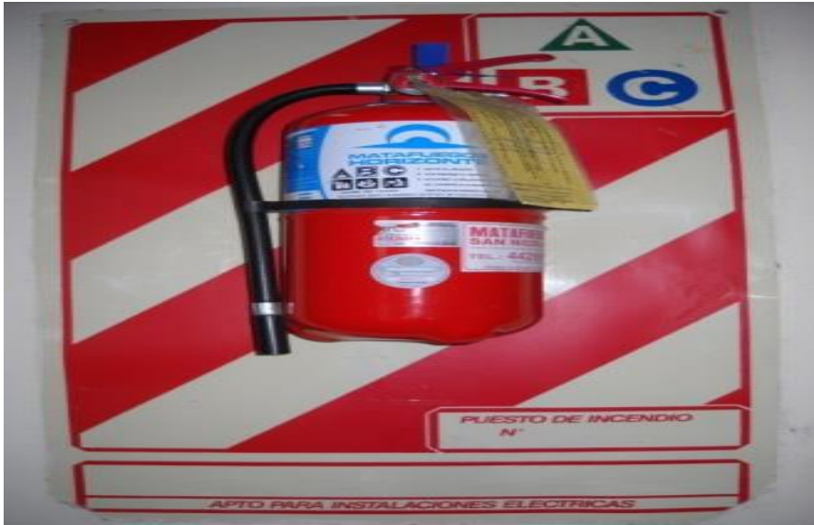
Figura 11- fuente propia. Extintor tipo ABC de 10 kilos completo de acuerdo a la reglamentación.
