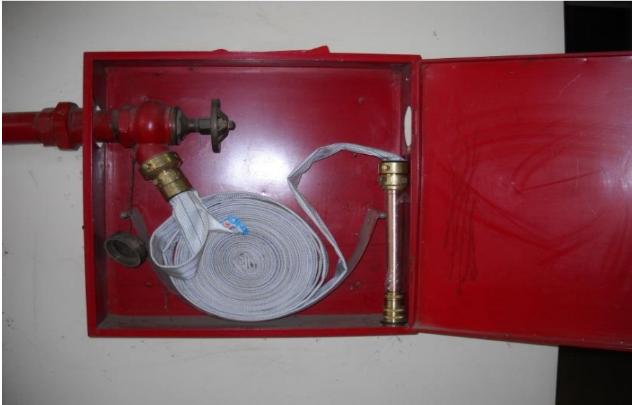
Figura 32- fuente propia. Caja de incendios.
