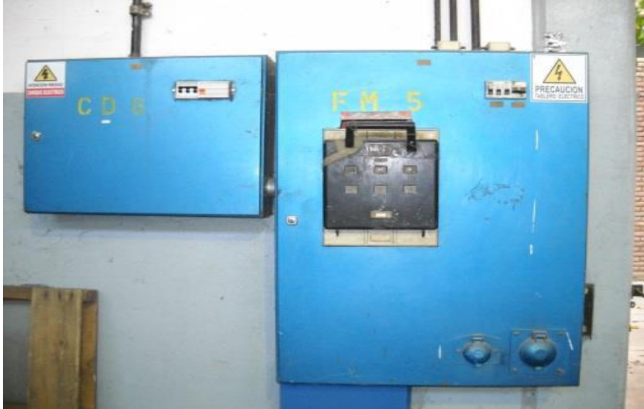
Figura 4- fuente propia. Tableros comandos para corte de energía por seccionador.
