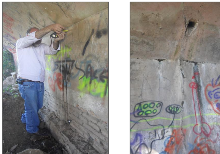
Figura 16 – Medida de inclinación del estribo y fisura longitudinal de una pila.
