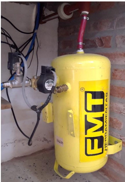
Foto 21. Tanque de aire
