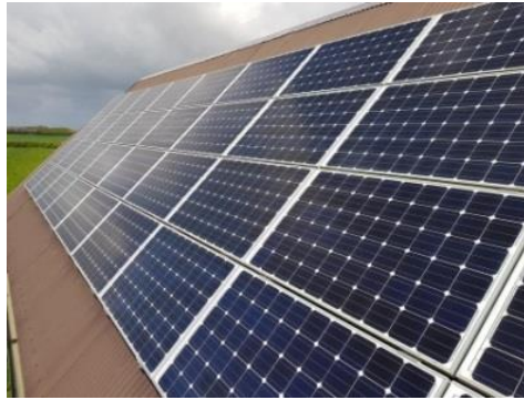
Fig.12 Paneles solares fotovoltaicos monocristalinos
