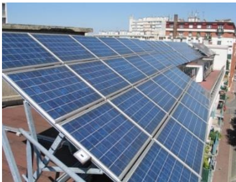
Fig. 13 Paneles solares fotovoltaicos policristalinos
