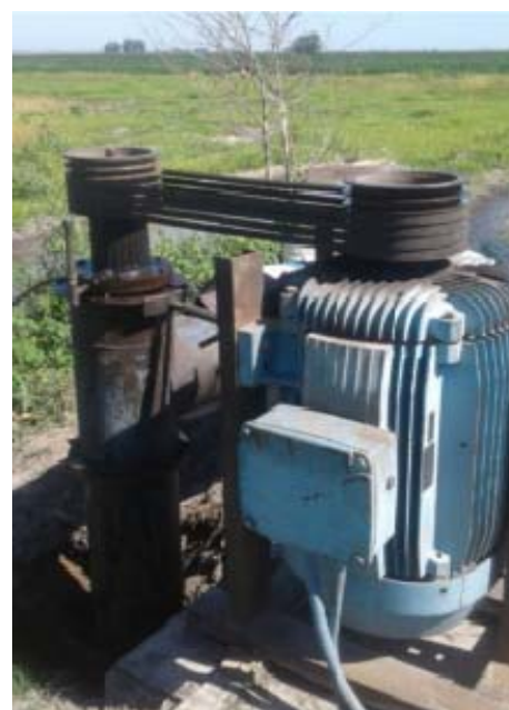
Fig. 1. Equipo de bombeo instalado actualmente.
