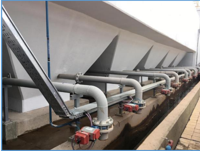
Figura 15: Sedimentador y cañerías de purga
