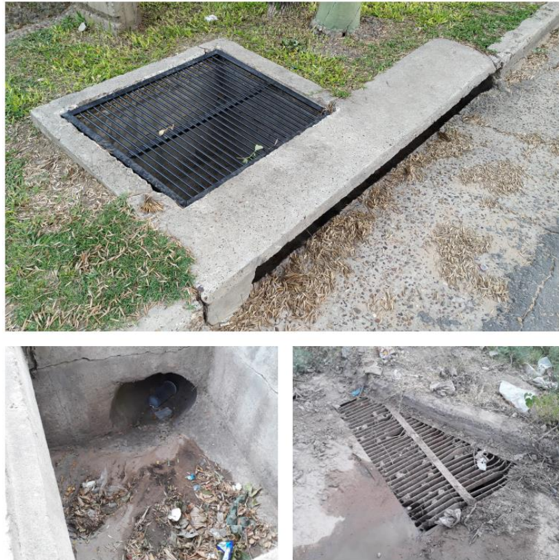
Ilustración 86 – Sumidero de ventana en JJ. Urquiza Fuente: Elaboración Propia
