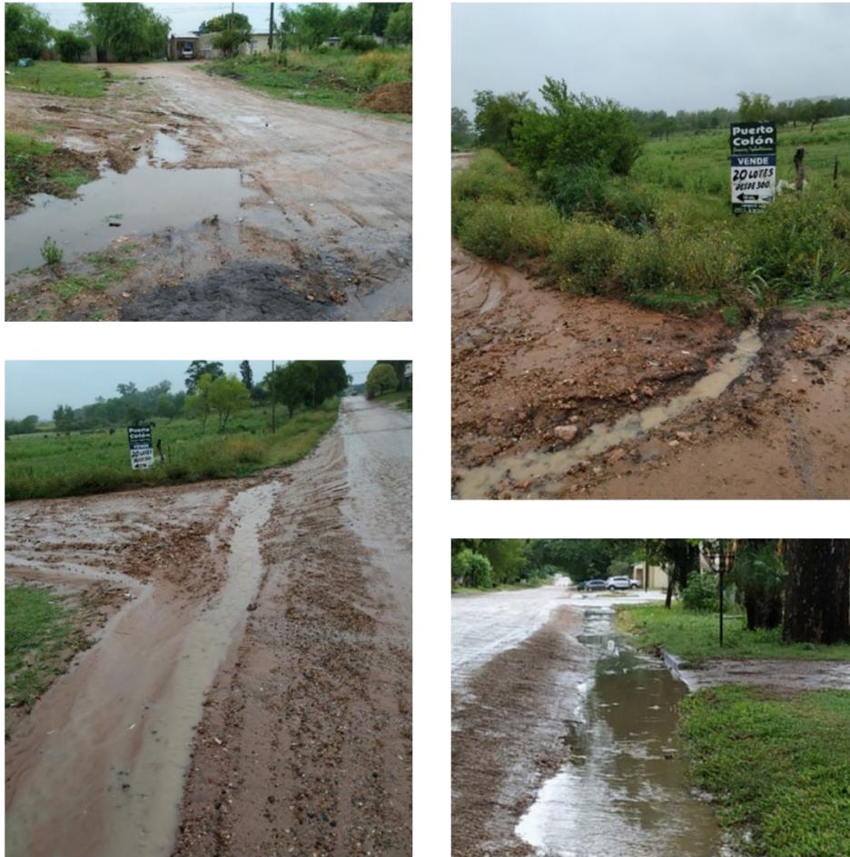
Ilustración 72 - Calles en cuenca Lantelme durante precipitación Fuente: Elaboración Propia
