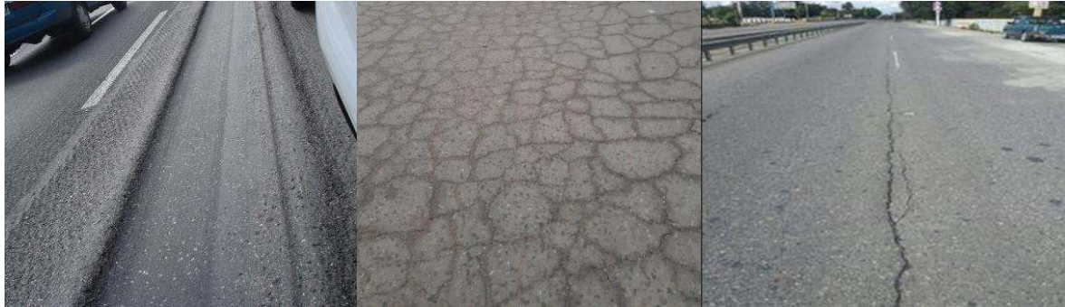
Fig. 1. Fallas presentes en el pavimento. Izquierda: Ahuellamiento. Centro: Fisuración por fatiga. Derecha: Fisuración térmica
