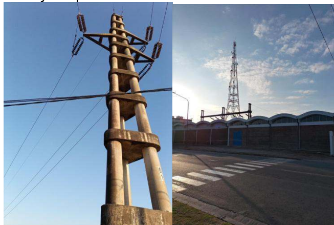
Figura 3 – Primer poste de medición y Estación Transformadora de Energía Eléctrica Norte ENERSA.
