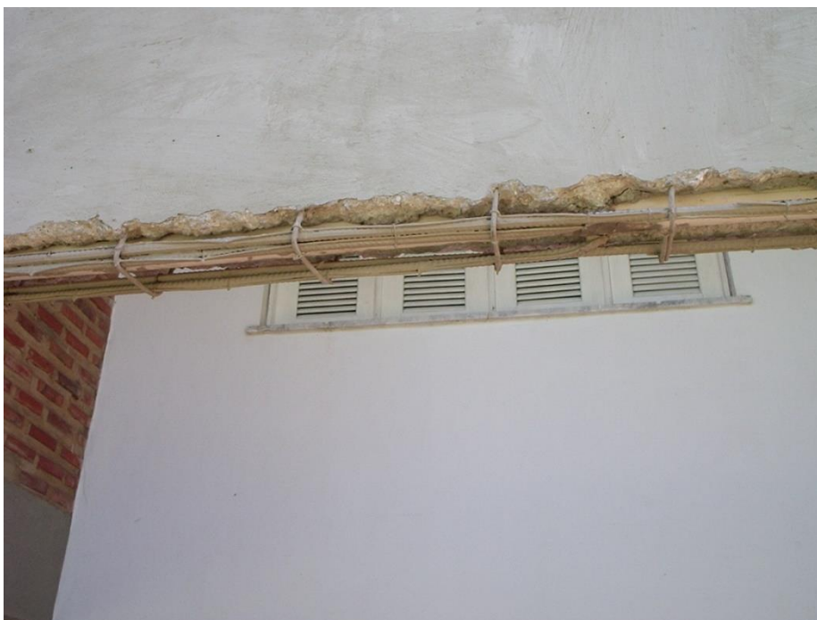
Figura 4.3.3. Viga da varanda de casa de Praia com tubo de pvc sobre as barras de aço.
