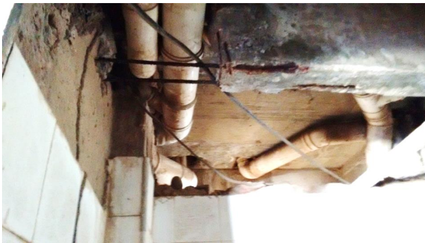
Figura 4.3.2: Remoção de concreto de uma viga para passagem de tubos de esgoto.
