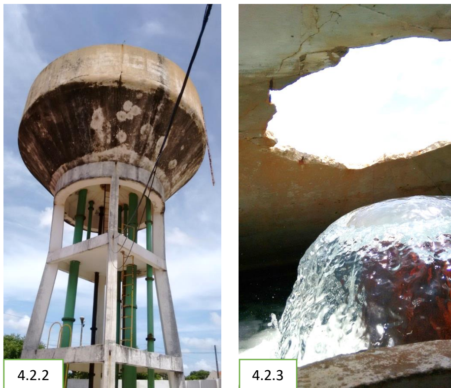
Figura 4.2.2. Reservatório elevado de água. Figura 4.2.3. Abertura na laje por golpe de aríete.
