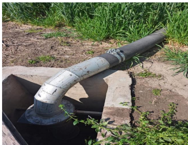
Figura N° 18: Cañerías subterráneas hacia la torre central.
