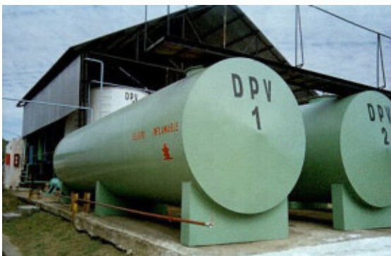
Tanques de almacenamiento, de materia prima (izq.) y en producto final (der.)
