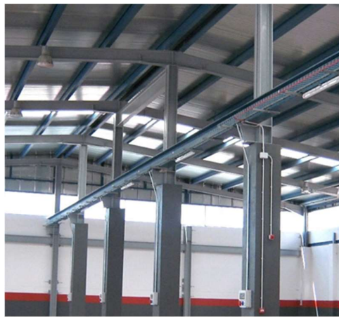
Figura 330| Instalación a la vista mediante sistemas de cable-canal. Fuente: https://sepae.es/index.php/project/instalacion-electrica-en-nave-industrial/
