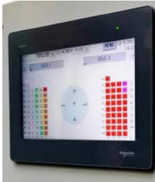
Imagen AIV.2 - Pantalla SCADA del sistema de Termometría – elaboración propia.
