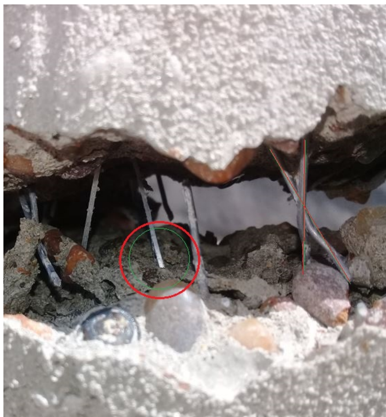
Figura 5.4: Macrofotografía de una grieta en un THRFH luego de la rotura. Las FA fallan por arrancamiento con rectificación del extremo conformado y las FPP por rotura. (González & Rougier, 2022)
