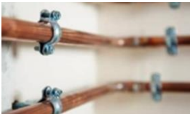
Ilustración 15: Tubería de cobre.
