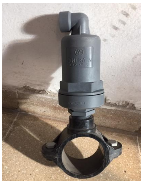
Figura 8: Válvula de aire de doble efecto colocada en el acueducto.
