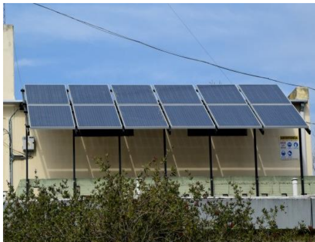
Fig. 1: Instalación solar fotovoltaica de la UTN Facultad Regional San Francisco.
