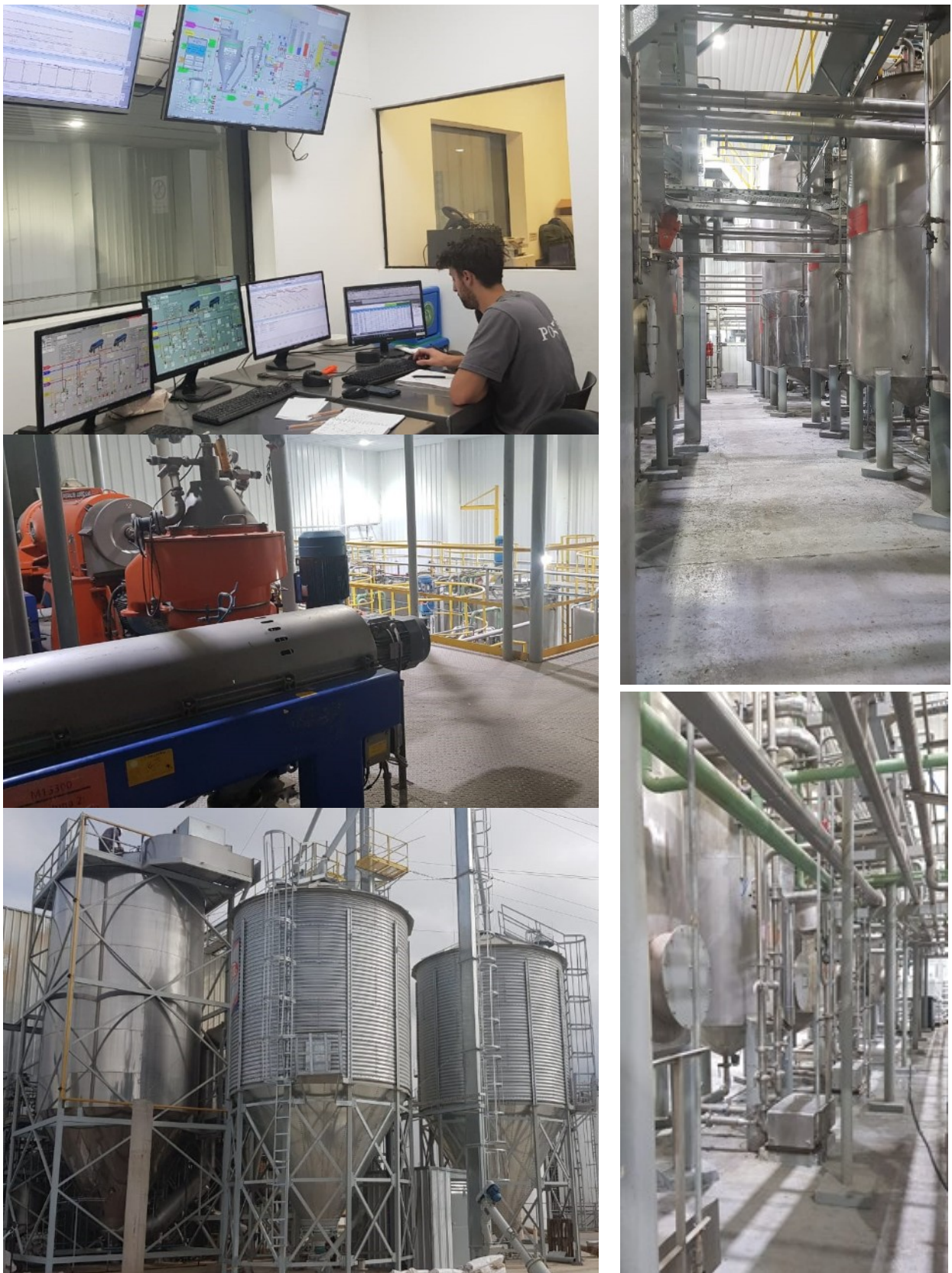
Figura 2: Planta de elaboración de SPC, sala de Control, separación, extracción, secado spray
