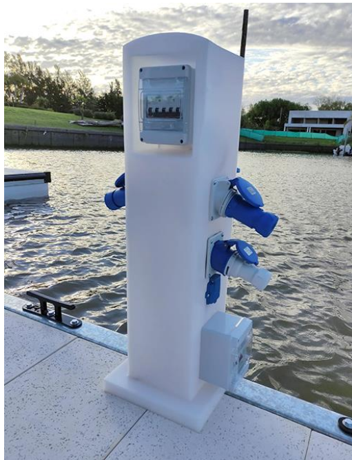
Figura 8.1.10. Torre de suministro
